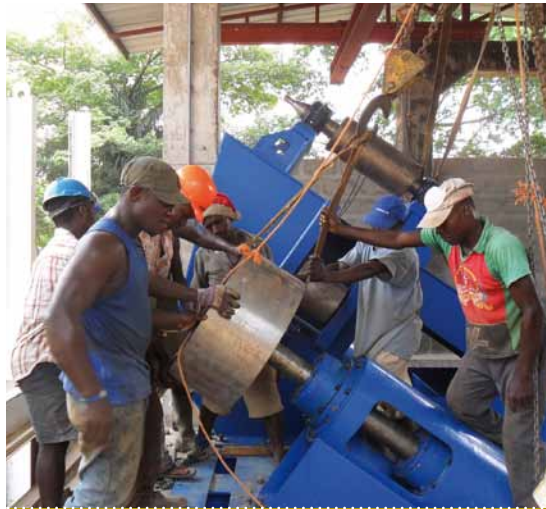
Het onderzoeken van de schade aan de turbines van de waterkrachtcentrale.
